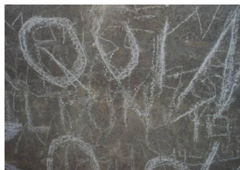
15-B: Pichações nos afloramentos calcários das imediações do Abrigo dos Oito
