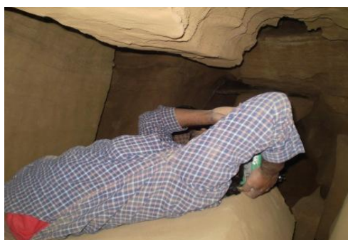
14-E: Fenda formada por deslocamento de bloco abatido.
